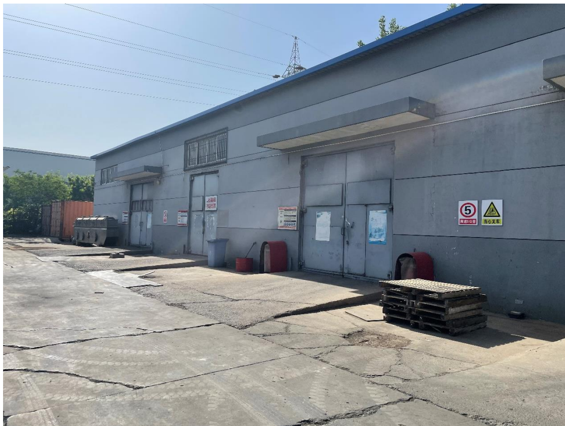
图 5-6 原料库周围地面裂缝
