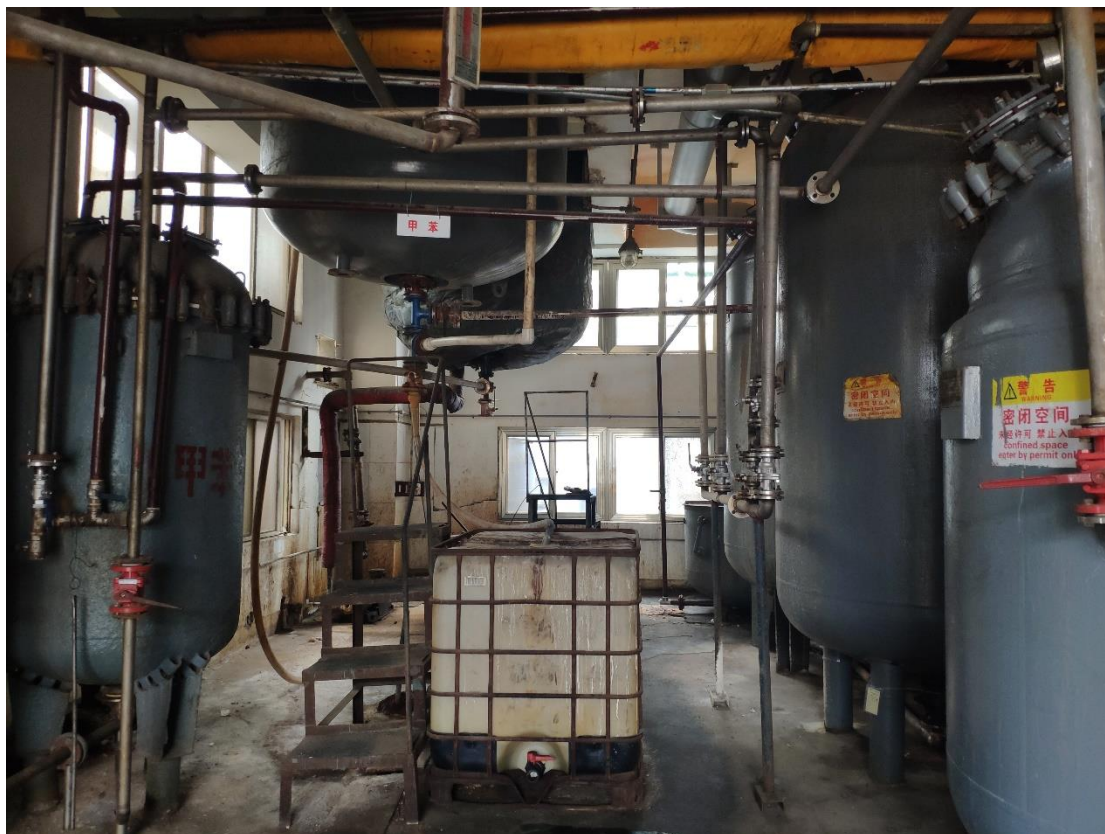
图 5-3 二车间物料输送管线与地面
