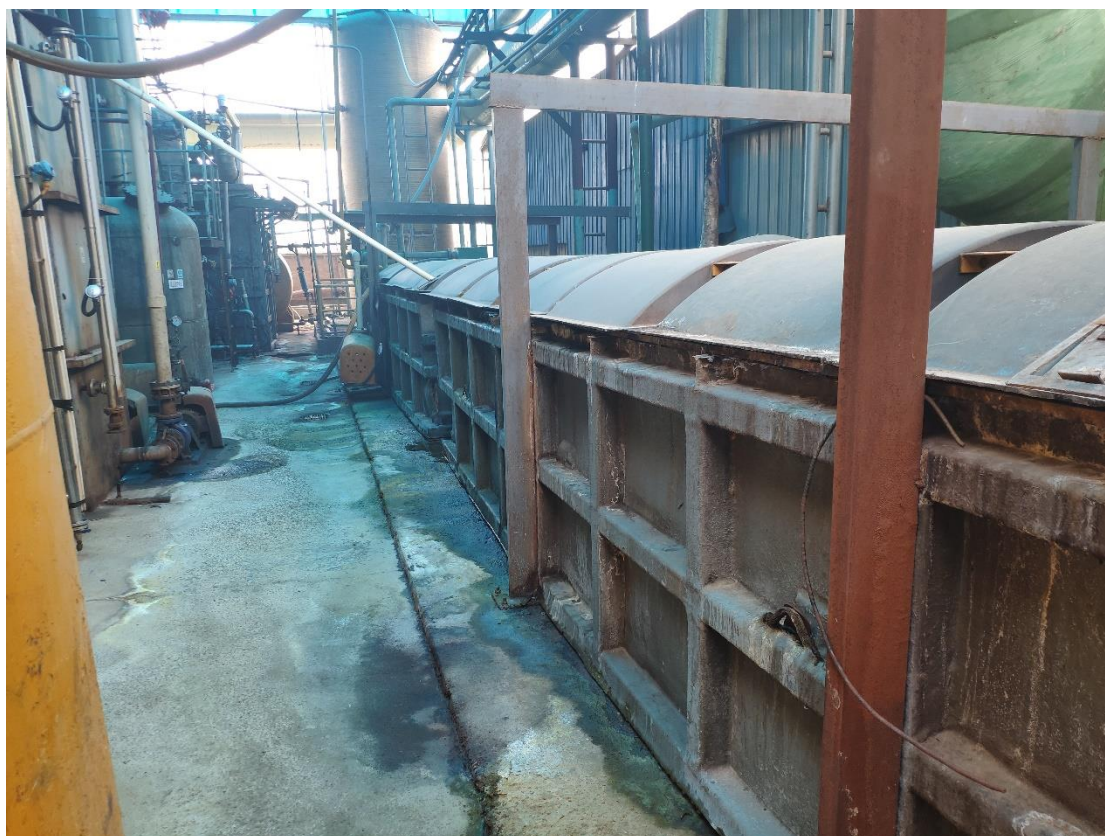
图 5-5 硫酸铵车间母液槽
