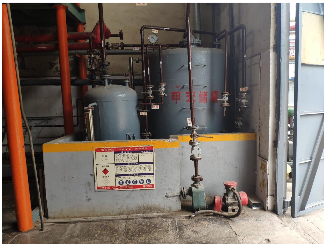
图 5-2 甲苯等原料通过地上管线输送
